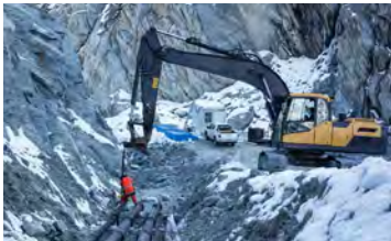
Beschneigungs- und Hochdruckleitungen
