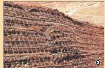
Foto 1: Der SteinSchlagschutzdamm aus bewehrter Erde ist nach dem Aufschlag beschädigt aber intakt.
